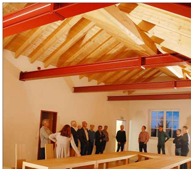
Beim Ortstermin wurde es klar: In Sachen Akustik besteht im neuen Sitzungssaal Handlungsbedarf. – Foto: Hölzlwimmer
